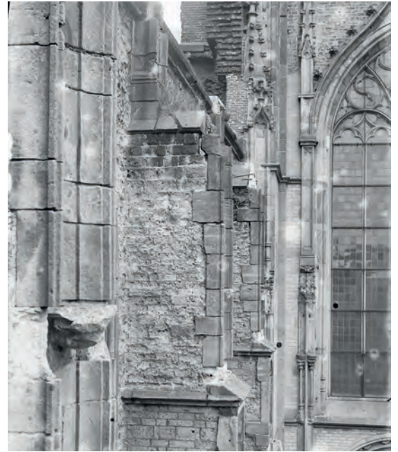
Slechte conditie contreforten is goed te zien (foto RCE 1931)
