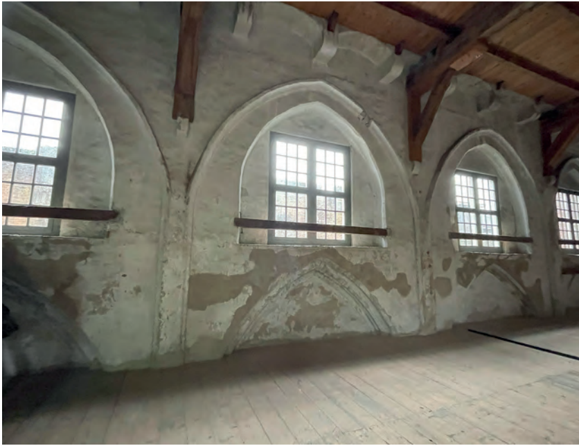
De verbouwingen uit het verleden zijn goed zichtbaar.
